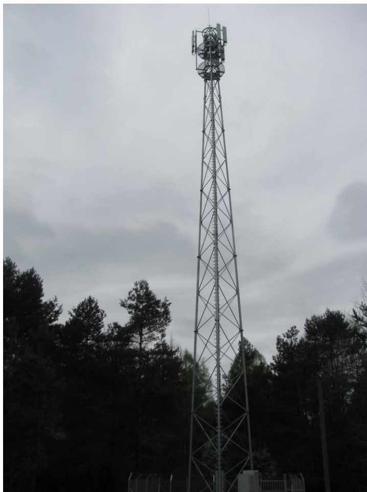
Zał. nr 1: Widok ogólny instalacji radiokomunikacyjnej.
